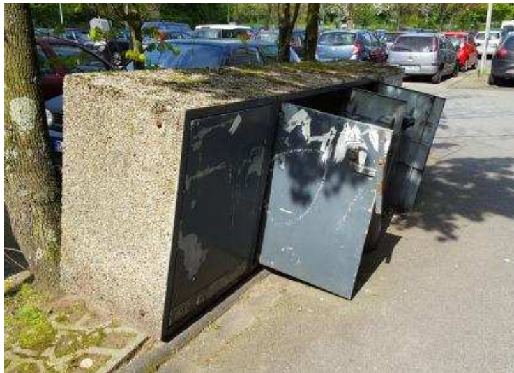
Parkplatz: Maroder Müll-Container
